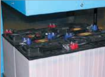
Gruppo batterie 24V. Unit batteries 24V.
